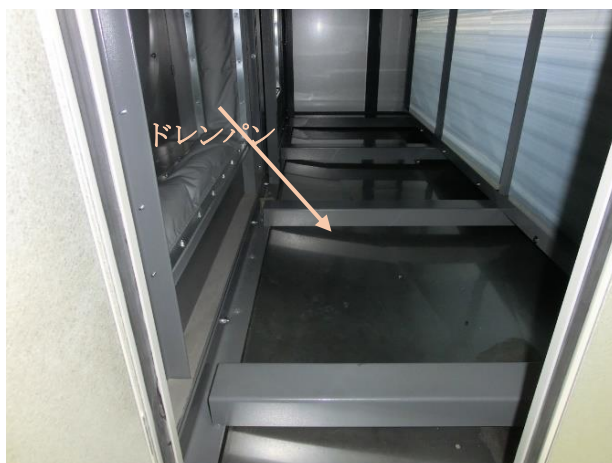
図-1 空調機内のドレンパン
