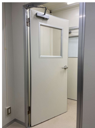
写真1 室圧変動抑制扉の外観
