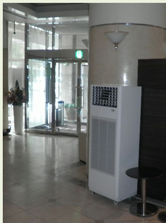
ドーミーイン仙台本店設置状況（1階ロビー）
